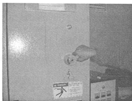
Cấp điện cho tủ điều khiển
