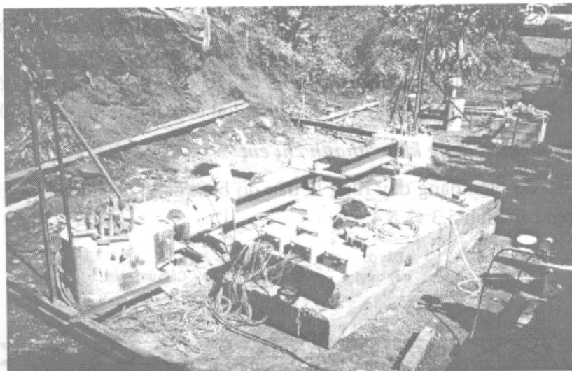
Hình 5.1: Hệ thống đầu thu nhận số liệu dùng để quan trắc hệ thống thiết bị trong một thí nghiệm tải trọng ngang.
