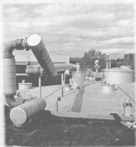
Hình 197: Thiết bị lắp trên bát úp của bể phân hủy
