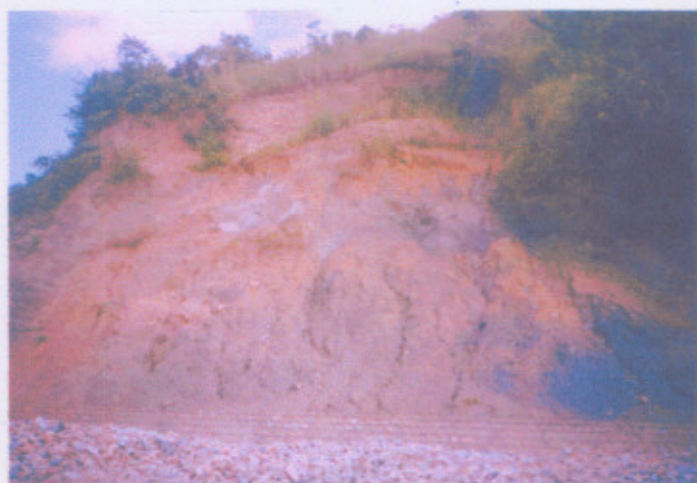
Ảnh 10 : Trượt lở lớn taluy đường QL12 bản Háng Lè xã Huổi Lèng. VPH độ dày lớn (30- 40m) phát triển trong trầm tích lục nguyên chứa than hệ tầng Lai Châu Ảnh: Nguyễn Quang Hưng- 2003
