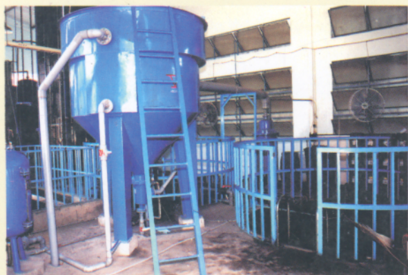
Hệ thống xử lý nước thải
