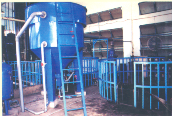
Hệ thống xử lý nước thải
