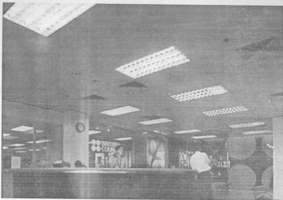
Các thiết bị thông gió và khử mùi được gắn âm trần
