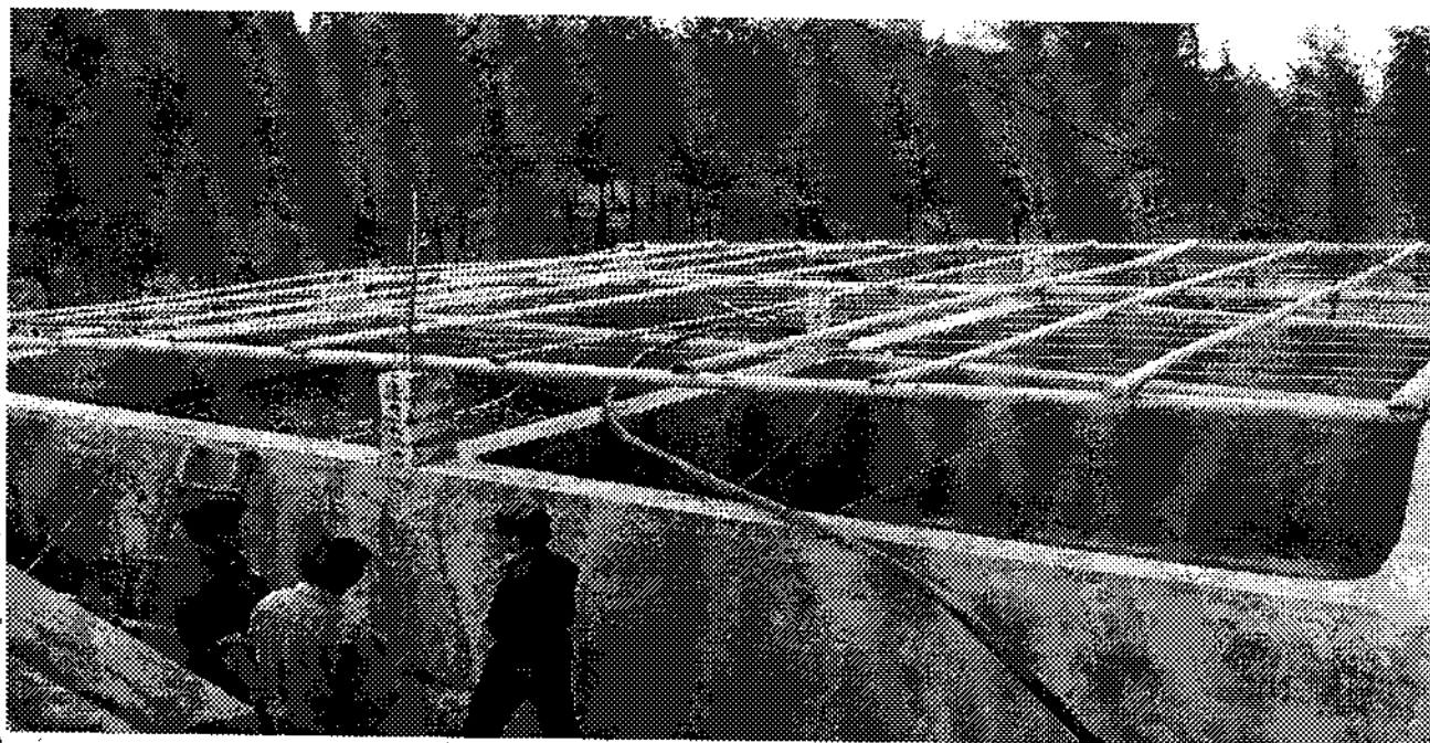
H9: Hệ thống xử lý nước ngoài trời trại tôm giống Quỳnh Liên
