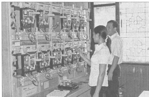
Kiểm công tơ điện trên bàn kiểm công tơ 12 vị trí tự động điều khiển được đầu tư qua dự án nâng cao năng lực Chi cục
