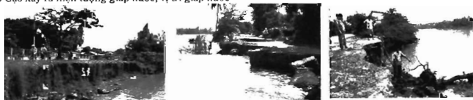
Hình 4. Sạt lở bờ kênh Chợ Gạo
