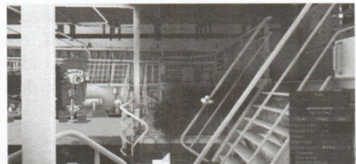
Hình 4.2: Khoang máy xảy ra hỏa hoạn
