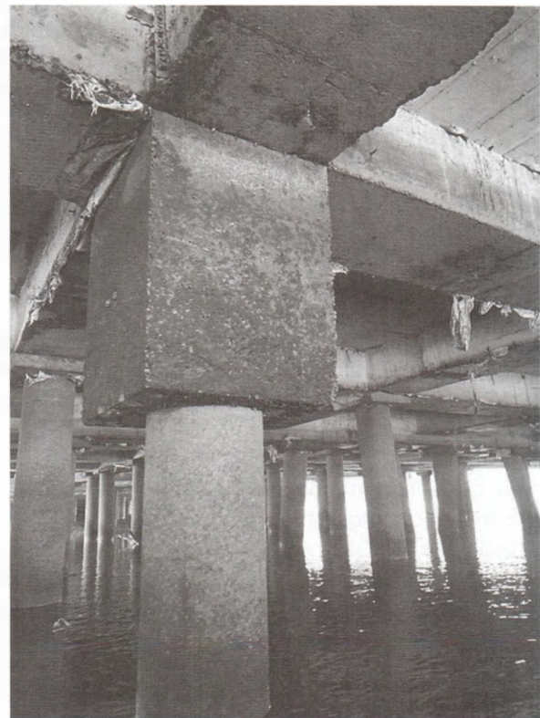
Hình 1.1: Cọc BTCT ứng suất trước cầu cảng bị nứt trong khu vực thủy triều lên xuống [1]
