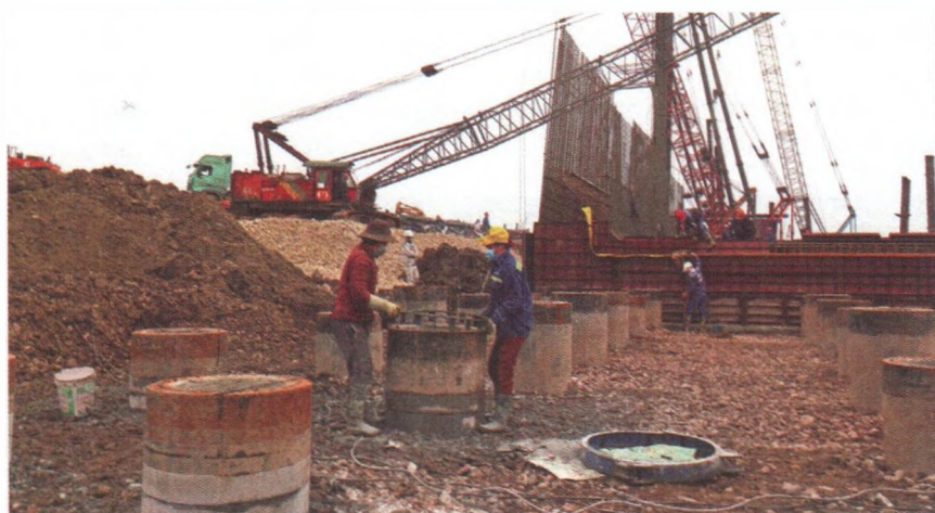
Thi công tại dự án Cụm công trình kênh nối sông Đáy và sông Ninh Cơ
