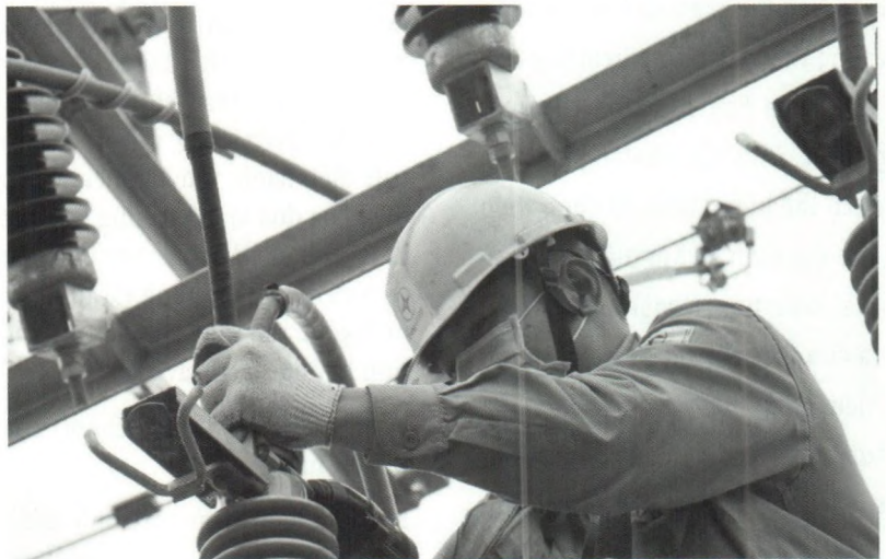
EVNHANOI đang nỗ lực đảm bảo cung ứng điện hè năm 2022.
