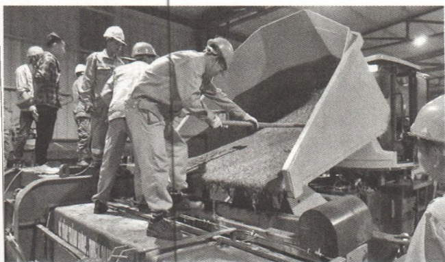
Hình 5. Thi công UHPC tại dự án sửa chữa mặt cầu Thăng Long
