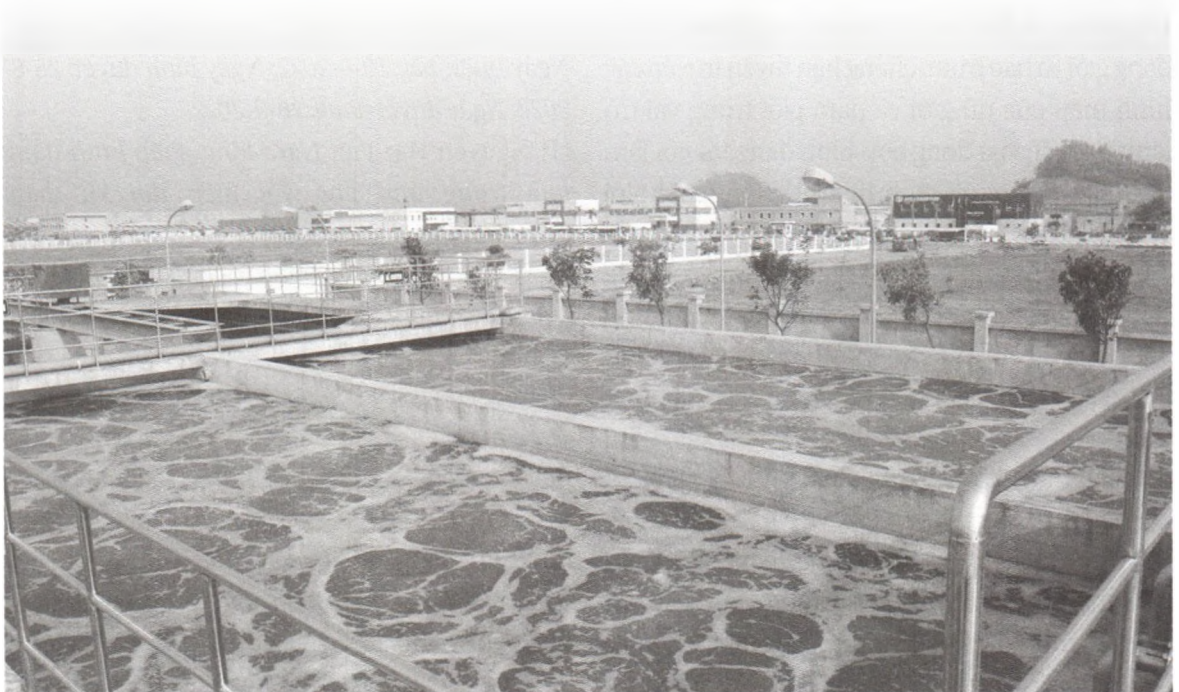
Khu xử lý nước thải tập trung tại Nhà máy xử lý nước thải Khu công nghiệp Diêm Thụy A
