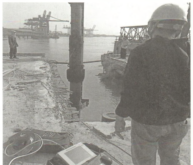
Hình 2.1: Thiết bị kiểm tra sức chịu tải của cọc theo phương pháp PDA [2]
