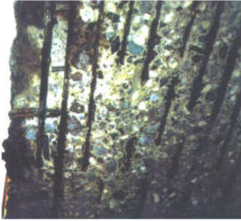
Hình 2. Cầu Shinmiya bị hư hỏng do ăn mòn cốt thép
