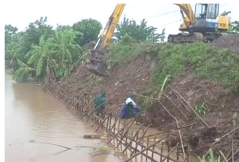
Hình 2. Sạt lở mái đê phía trong đồng, đoạn đê cửa sông Tả Hồng Hà-Thái Bình
