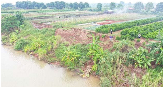
Hình 1. Sạt lở tại bờ bãi sông Hồng đoạn đi qua thôn Sơn Hô huyện Gia Lâm
