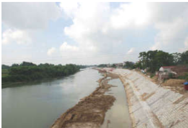
Hình 3. Kè bằng các tấm bê tông cốt thép trên sông Cầu – Thái Nguyên
