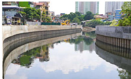
Hình 4. Kè bê tông dự ứng lực trên kênh La Khê – Hà Đông
