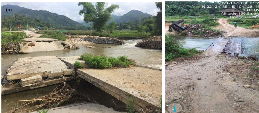
Hình 1. Cầu Bán Kem (a) và cầu Bán Lăng (b) xã Nghĩa Đô bị hư hỏng nặng sau đợt lũ quét năm 2018, hiện vẫn đang chờ kinh phí sửa chữa (Ảnh: Phạm Quang Anh).
