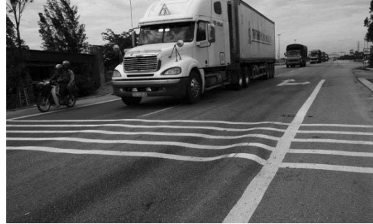
Hình 1 - Hẳn lún vệt bánh xe dưới tác dụng của tải trọng trùng phục [Nguồn Báo Giao thông - Bài báo "Bê tông nhựa loại thường không phù hợp nắng nóng miền Trung" - 28/06/2015]
