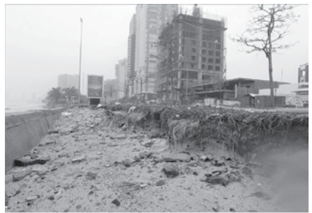
Bão số 13 (tháng 11/2020) gây xói lở bờ biển Đà Nẵng.
