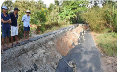
Sụt lún trên tuyến đường Co Xáng - Cơi Năm - Đá Bạc (Cà Mau)
