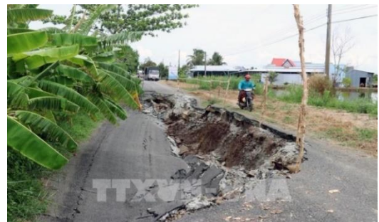
Sụt lún, sạt lở đường Tỉnh lộ 965 (Kiên Giang)
