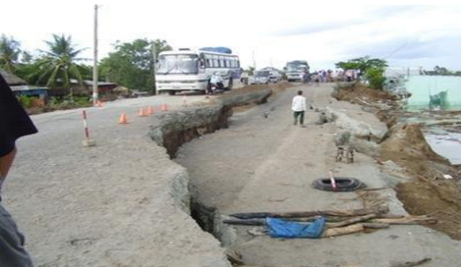
Sạt lở đất và lún mó cầu, trên QL1A (Bạc Liêu)
