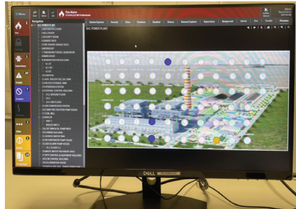
Màn hình điều khiển hệ thống phòng cháy, chữa cháy trên máy tính.
