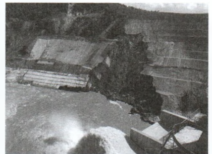
Hình 1. Hiện trạng mái đào bị sạt lở [1]
