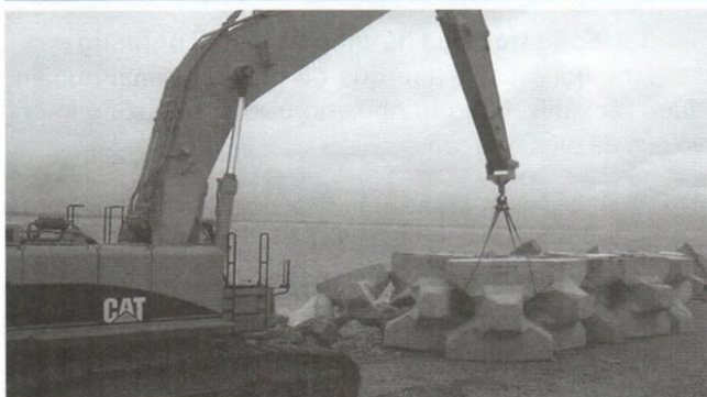
Hình 2.6: Accropode sử dụng tại đê chắn sóng cảng Dung Quất - Quảng Ngãi
