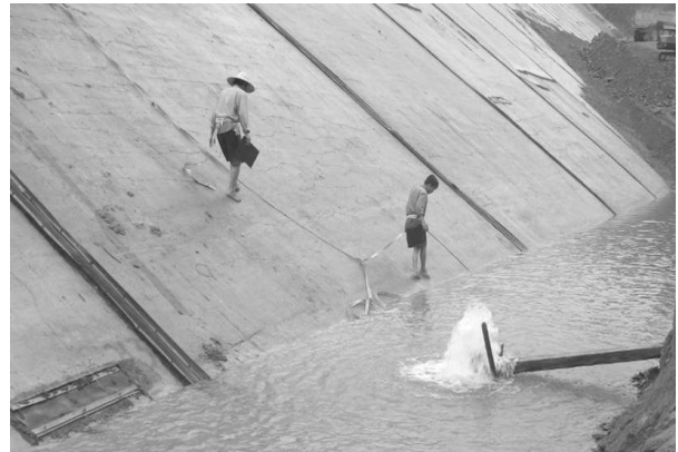
Hình 10. Nước phun tại khớp nối giữa tấm T30 và T31
