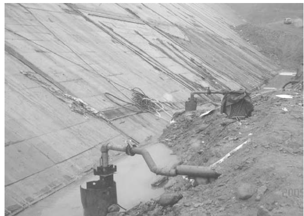
Hình 8. Bơm tiêu nước từ giếng tiêu nước ra ngoài đê quai
