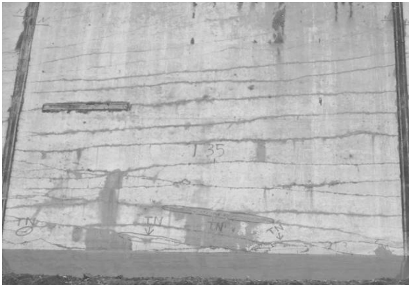
Hình 9. Các vết nứt trên tấm BMBT số T34
