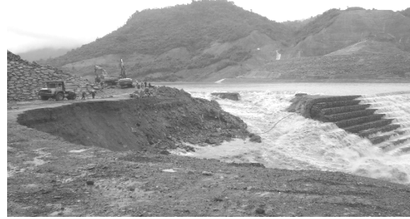
Hình 3. Phần bờ sông và mặt đập bị xói lở
