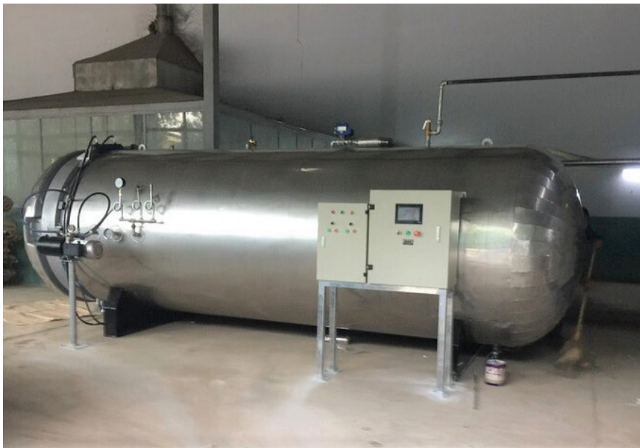
Hệ thống hấp khử trùng rác thải y tế tại URENCO 13.
