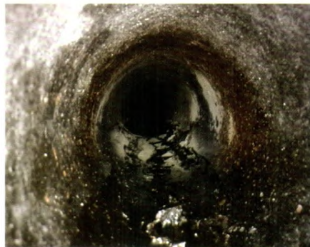
Hình 2. Bên trong đoạn nằm ngang trên MSP-9 của đường ống MSP-9 → MSP-11.
