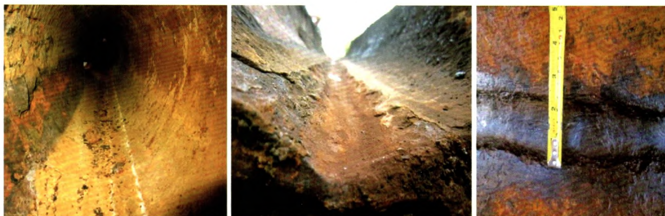
Hình 6. Ăn mòn bên trong đường ống vận chuyển nước bơm ép MSP-8 → MSP-9 tại vị trí 6 giờ.
