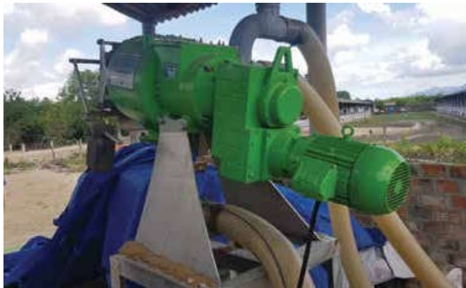
▲ Trang trại của ông Nguyễn Văn Thi (tỉnh Bình Định) đã đầu tư đầy đủ hệ thống máy tách ép phân trước khi cho nước thải xuống hầm biogas
