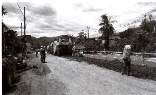
Hình 4.2: Dây chuyền thi công lớp tái sinh nguội tại đường Hùng Vương, quận Hồng Bàng, Hải Phòng
