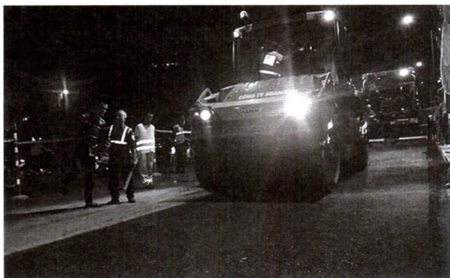
Hình 4.1: Tổ chức ATGT khi thi công vào ban đêm tại đường Lạch Tray, Ngô Quyền, Hải Phòng
