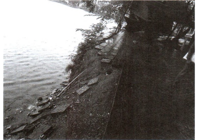
Hình 1.1: Kè hồ bằng tường chắn bị mất ổn định
