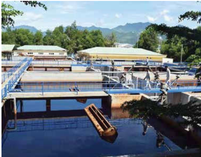
▲ Hệ thống xử lý nước thải tập trung của KCN Hòa Khánh
