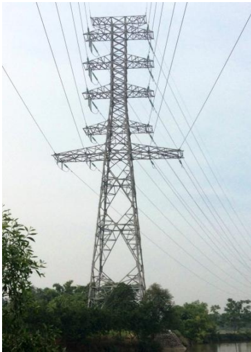
Hình 1. Đường dây bốn mạch 2×220 kV (phía trên) và 2×110 kV (phía dưới)
