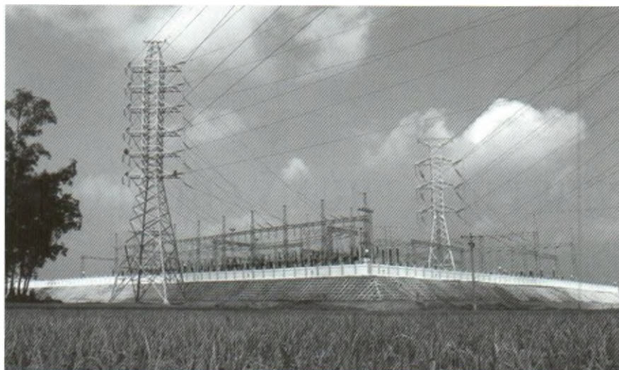
Trạm biến áp 220 kV Phú Bình cấp điện cho Samsung Thái Nguyên.
