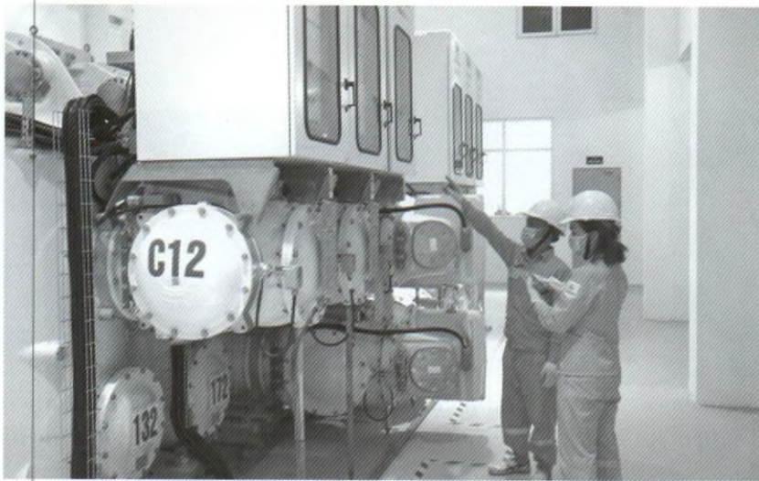
EVNHANOI sử dụng các thiết bị GIS, hợp bộ đóng cắt Compact.
