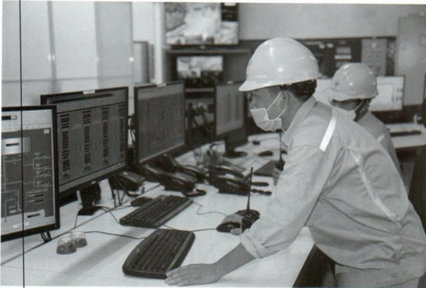
Angoài nhiệm vụ phát điện, các nhà máy thủy điện của Công ty ĐHD còn cung cấp nguồn nước dồi dào, ổn định cho sản xuất nông nghiệp tại địa phương
