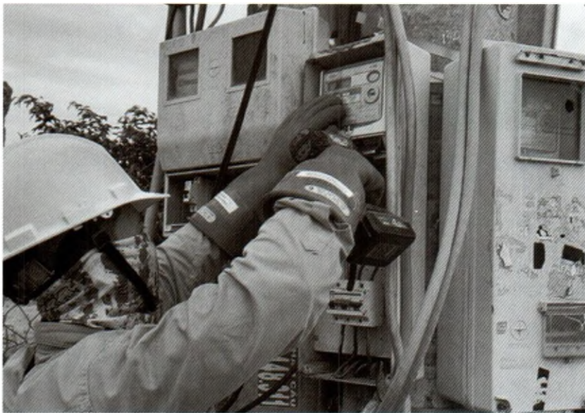
Kiểm tra hệ thống đo đếm của khách hàng, áp giá đúng mục đích sử dụng điện.
