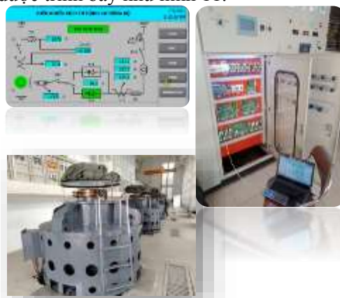
Hình 10. Phần mềm SCADA, tủ điều khiển và động cơ đồng bộ
