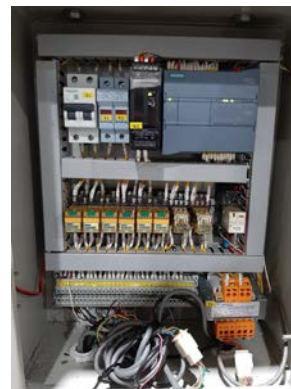
Hình 6. Bên trong tủ điều khiển.
