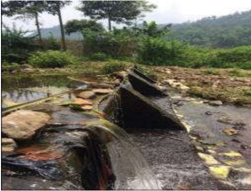
Hình 22: Hiện trạng công trình đập Phai Vọng
