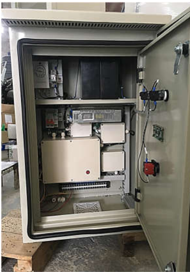
Hình 14. Hình ảnh tủ điều khiển.
