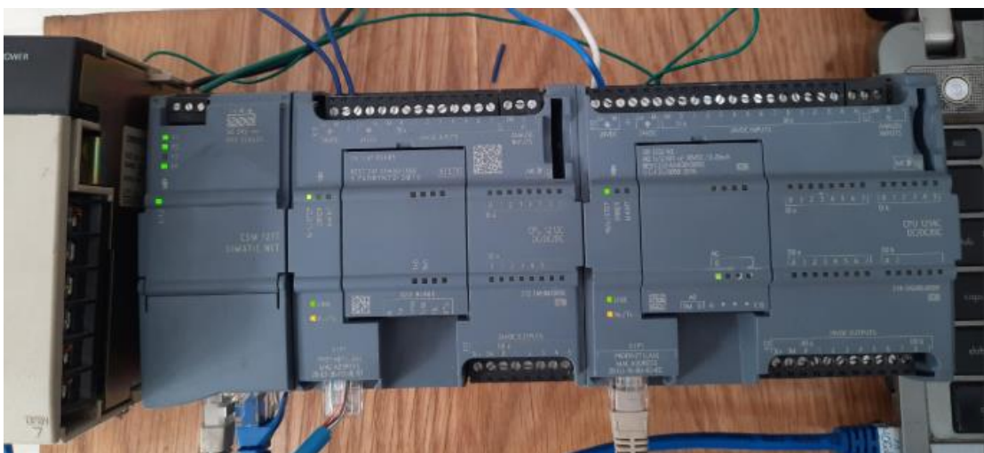
Hình 3. Kết nối phần cứng truyền thông PLC thực tế
