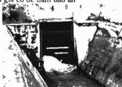
Hình 9. Nước rò rỉ ở cửa van tràn xả sâu tràn hồ Đá Bạc
